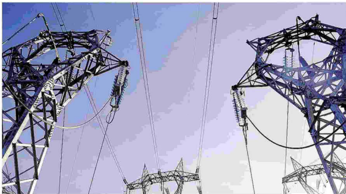
Tralicci per il trasporto dell'energia elettrica. Il prezzo è stabilito quotidianamente dalla Borsa elettrica
